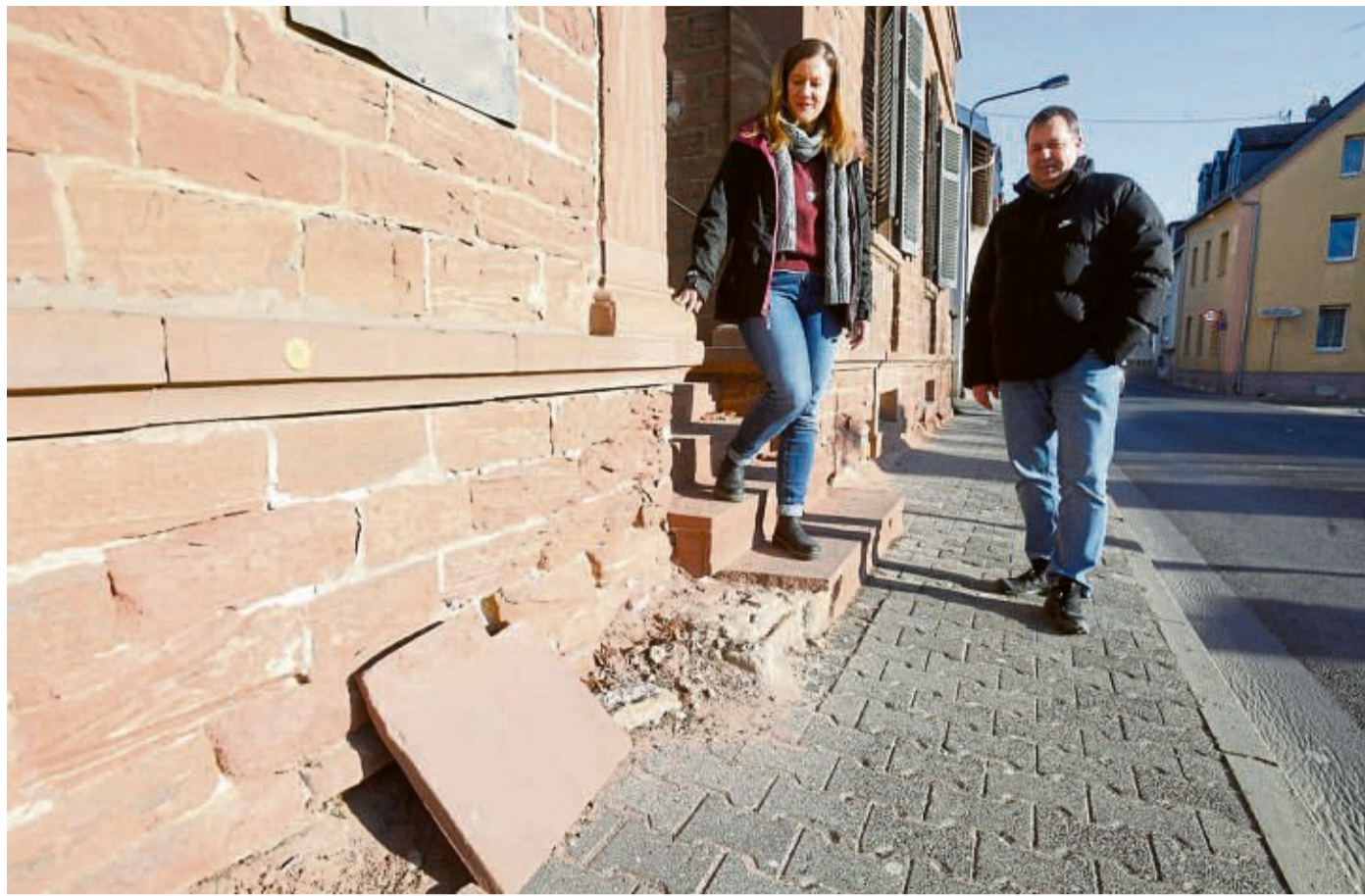
Ortsvorsteherin Susanne Serke (CDU) und Andreas Will, der Vorsitzende des Sossenheimer Heimat- und Geschichtsvereins, bemühen sich um die Reparatur der Schäden am alten Rathaus. Die Treppe ist seit einem halben Jahr kaputt. FOTO: MAIK REUSS
